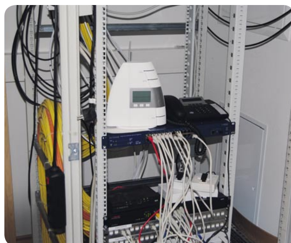
Bild 2: Herz der Gebäudetechnik auf dem Schiff – die in das Schiffs-LAN eingebundene HomeMatic-Zentrale CCU 1
