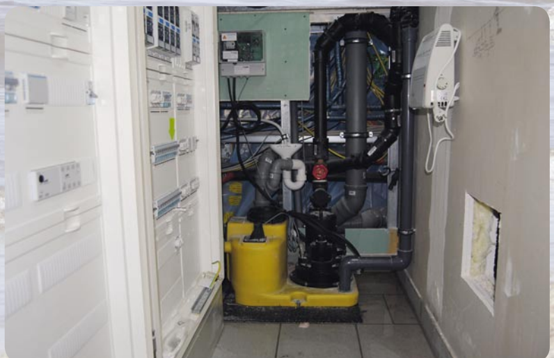
Bild 8: Auch die Abwasserpumpen und weitere technische Einrichtungen werden von der HomeMatic-Zentrale überwacht.
